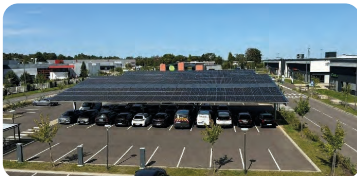
Début de la première année de pleine exploitation de la toute première installation de panneaux photovoltaïques par la CCPO sur le parking du RES'O.
